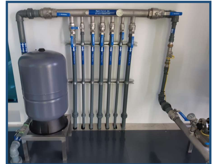
Manifold de distribución de agua potable al edificio
