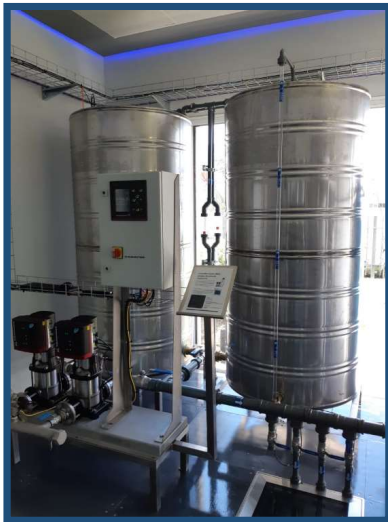
Tanques de almacenamiento de agua potabilizada
