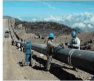
Gasoducto de Transporte
